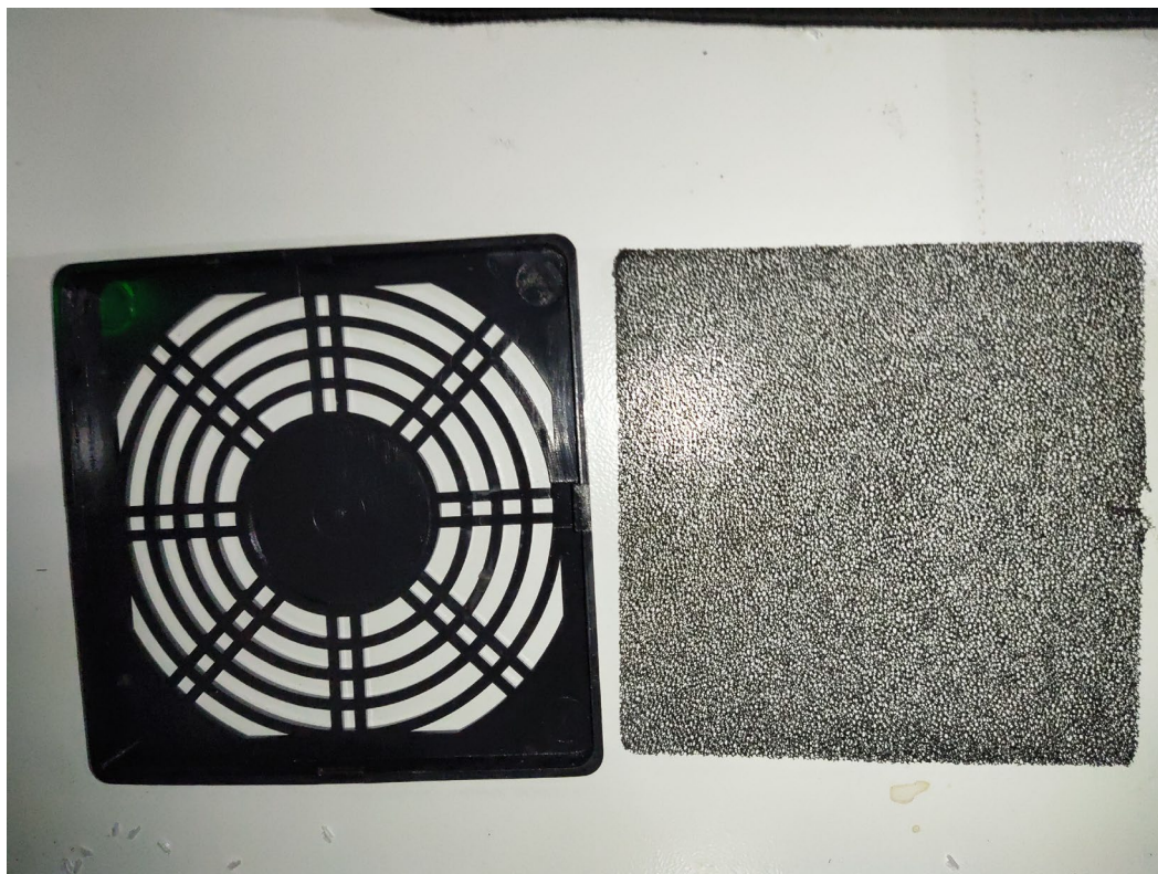
Рис. 10 Состояние фильтров шкафа управления.
